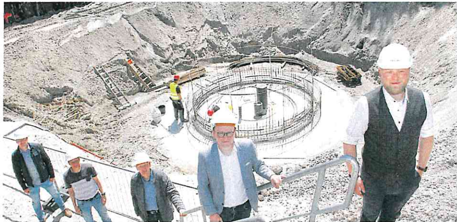
Informierten über das Projekt (v.l.): Henning Rolles (Bauamt), Kläranlagen-Leiter Frank Broer, Ewald Bley (Bauamtsleiter), Bürgermeister Thomas Höffmann und Enno Klaaßen vom Ingenieurbüro Born und Ermel.
