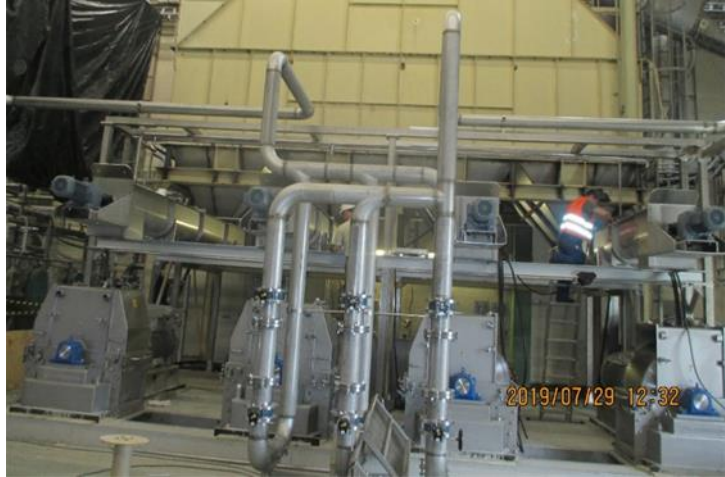
Kartoffelbunker, Reibemaschinen inkl. Rohrleitungsbau
