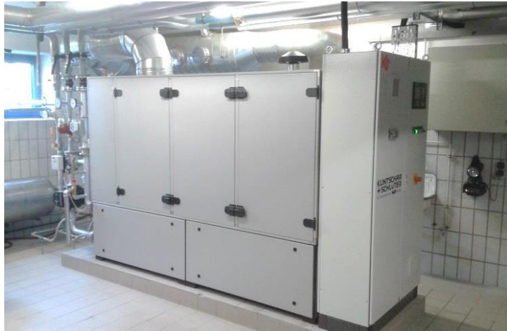
Blockheizkraftwerk Kläranlage Windecken
