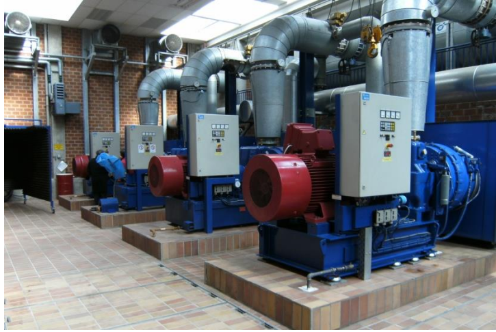
HV-Turboverdichter (4 x 17.000 Nm 3 )
