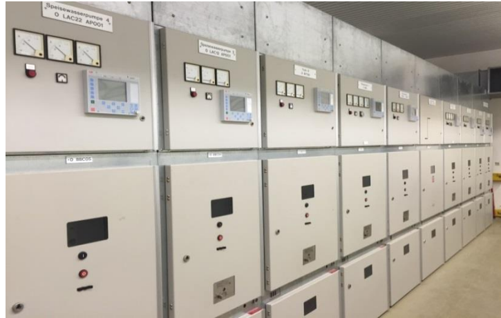
MS – Schaltanlagen ausgerüstet mit neuen Schutzgeräten
