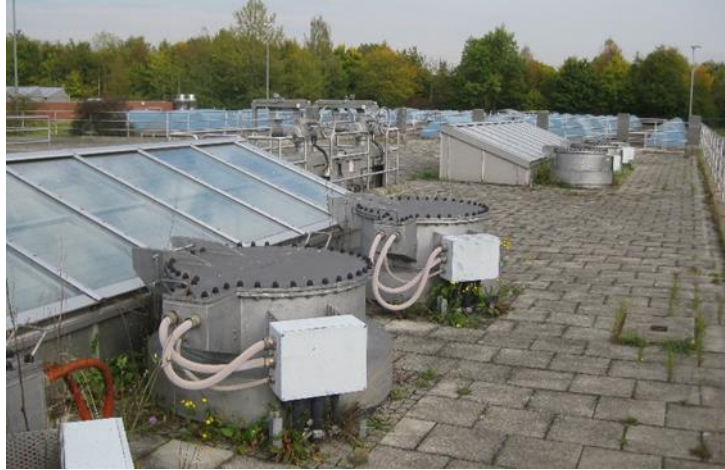
Filterhebework und Sandfilteranlage
