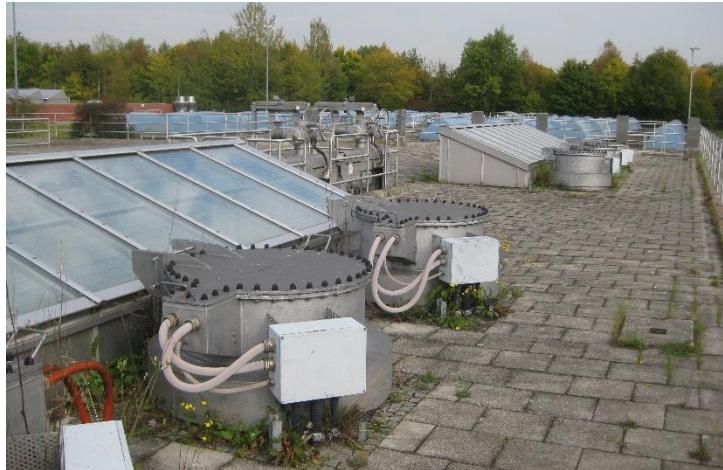
Filterhebewerk und Sandfilteranlage
