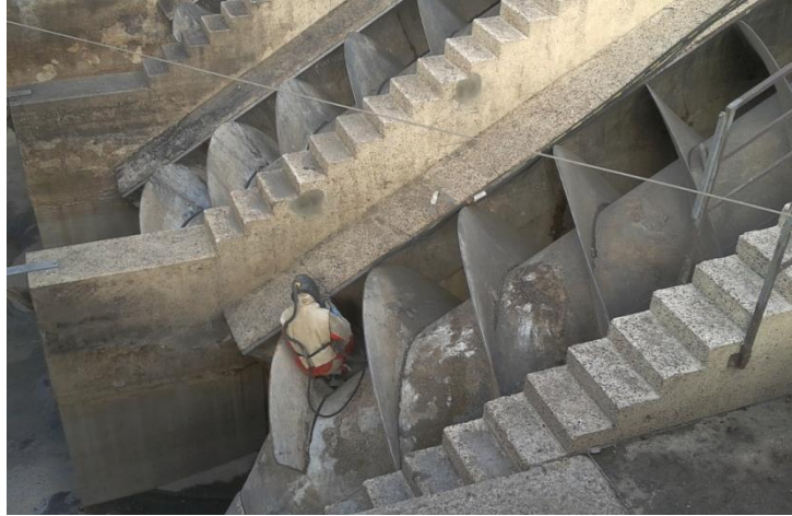
Pumpwerk Links, Regenüberlaufbecken
