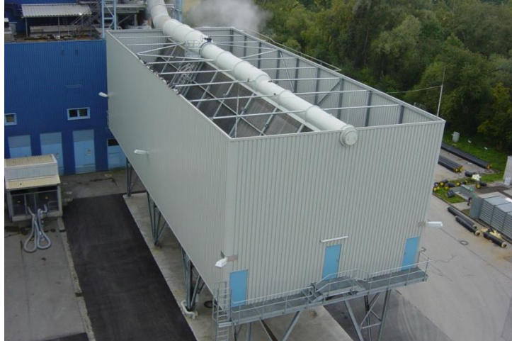
Luftkondensator nach Entnahme-Kondensationsturbine
