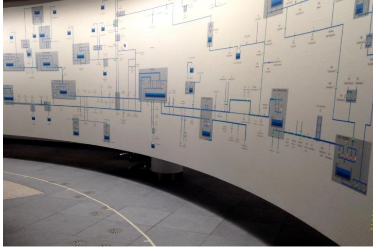
Meldebild Zentrale Schaltwarte Stuttgart
