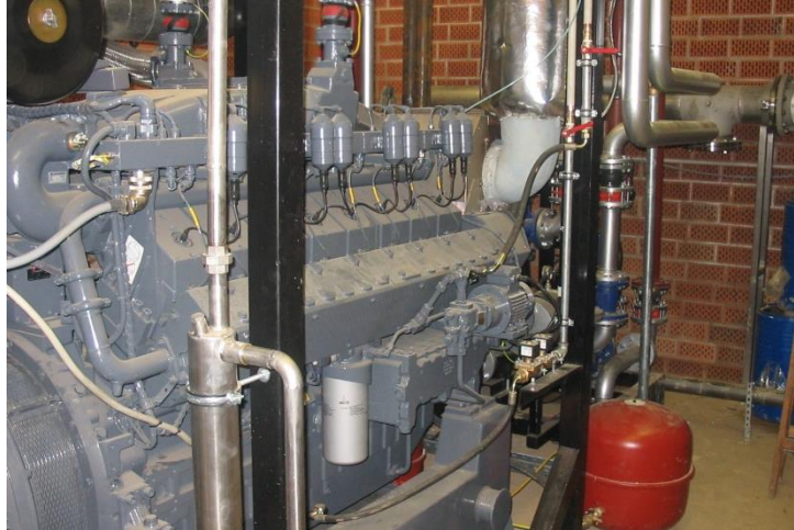
BHKW Deutz TCG 2016 B V16
