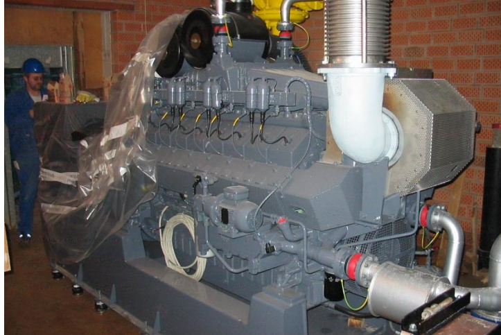
BHKW Deutz TCG 2016 B V16
