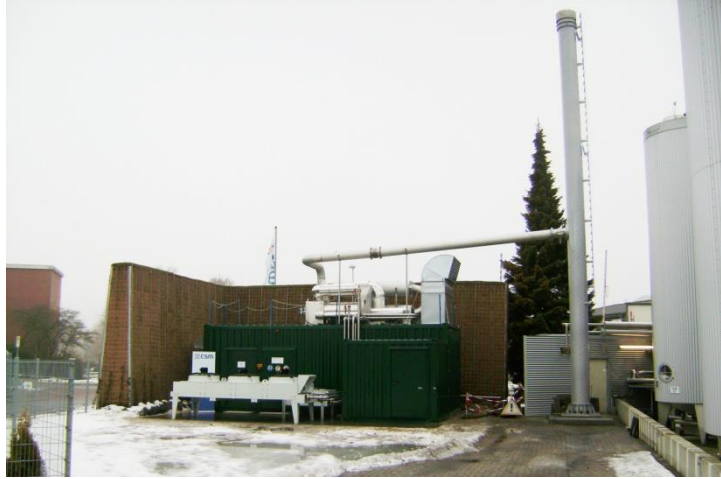
BHKW Werksgelände CSM
