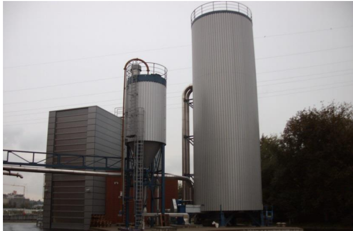
Annahmestelle mit Außensilos
