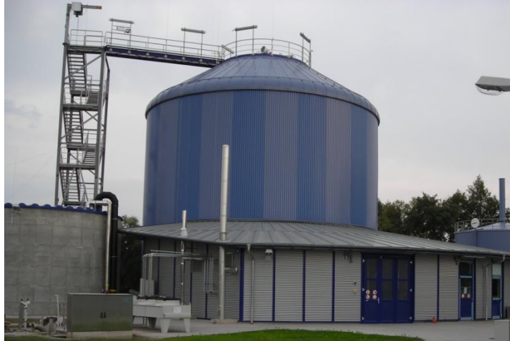
Schlammfaulung und Betriebsgebäude
