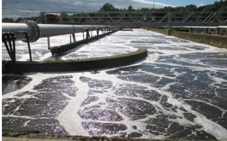
Belebungsbecken der Kläranlage Bergen
