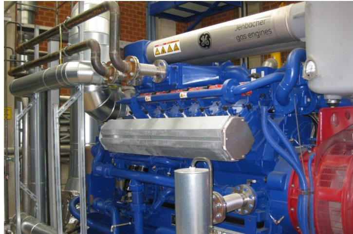
Neues BHKW-Modul der Fa. Jenbacher
