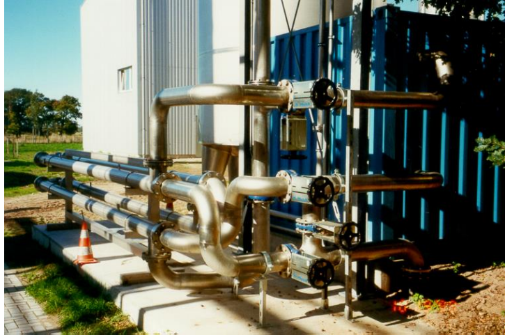
Wärmetauscher, Zwischenspeicher und Maschinenraum
