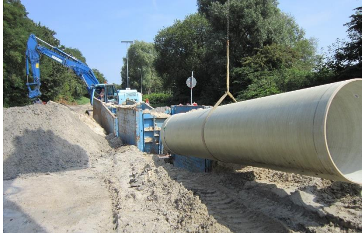
Druckrohrleitung DN 1200 am Pumpwerk-Süd
