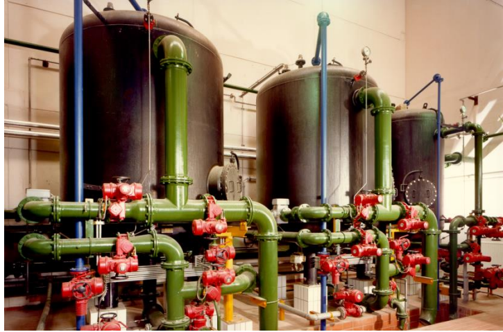
Kiesfilterstation der Betriebswasseraufbereitungsanlage
