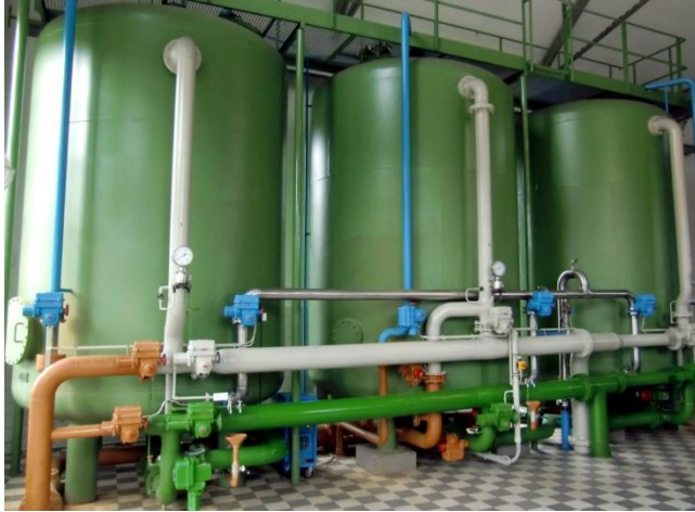
Filterbehälter WW Buxtehude
