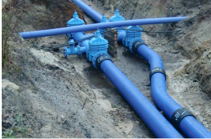
Rohwasserleitung mit Schieberkreuz für Brunnenanschluss
