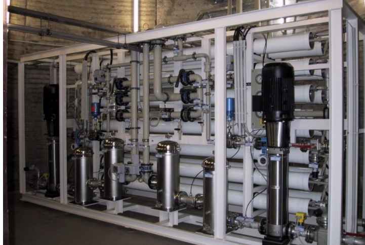
Ansicht der Umkehrosmoseanlage
