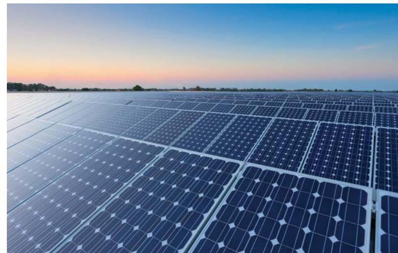
Abb. 5.1.1: Photovoltaik-Freiflächenanlage | Quelle: Fotolia
